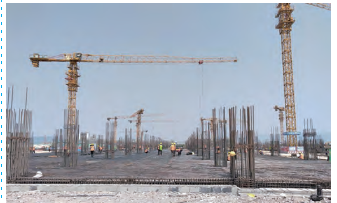
近日,凯实金桥公司强化项目进度考核,督促施工单位加大人力、物力的投入,推动项目建设按计划、形象进度组织实施。(郁洪兵)
